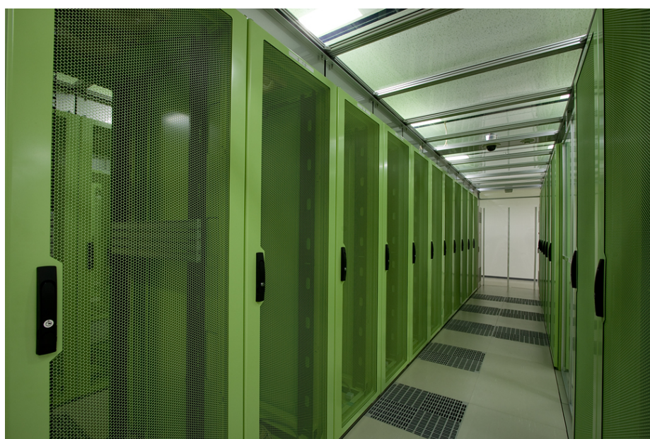
さくらインターネット堂島データセンター 新フロア
