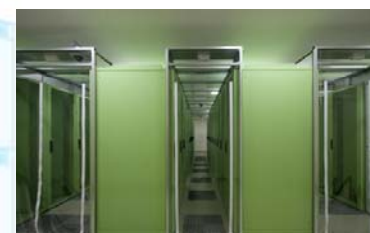
▲堂島データセンター
