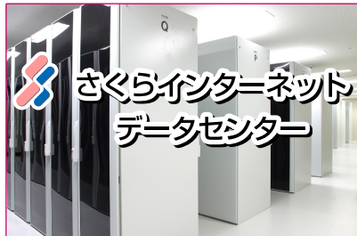
都市型データセンター
